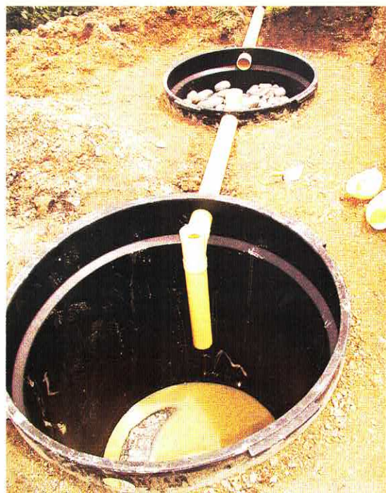
Ejemplo de instalación de sistema séptico prefabricado, con trampa de grasas (el sistema incluye cubierta de pozos, no mostrado en la foto).
