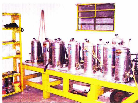
Buen estado de los equipos de aplicación.
