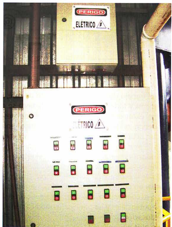
El análisis de riesgos permite realizar mejoras, un ejemplo de prevención es la seguridad de las instalaciones eléctricas.
