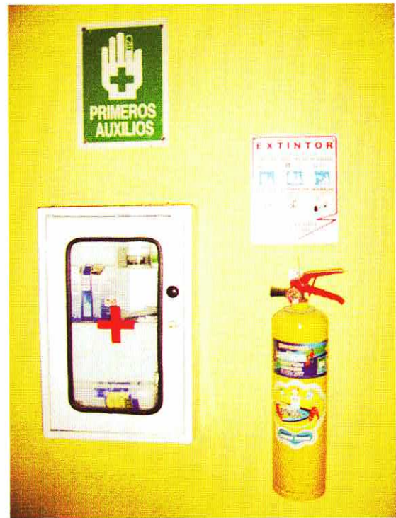
Botiquín de primeros auxilios y extintor de fuego, localizados en lugar al acceso de los usuarios capacitados. Señalización.
